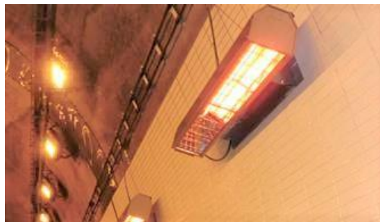
トンネル向け融雪装置
